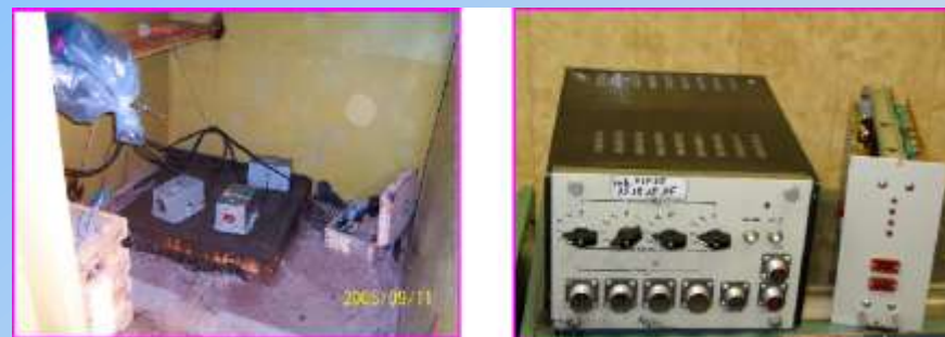
Комплект каналов на базе сейсмометров (слева) и БСК (справа).
