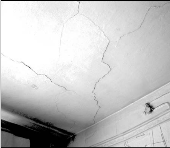
Рис. 4. Трещины в штукатурке потолка
