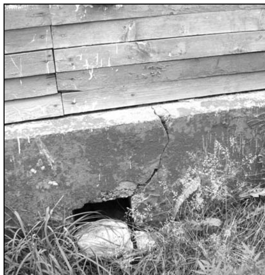
Рис 8. Широкая трещина в фундаменте
