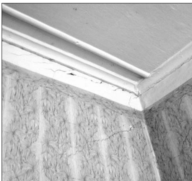
Рис. 9. Трещины над и под обоями
