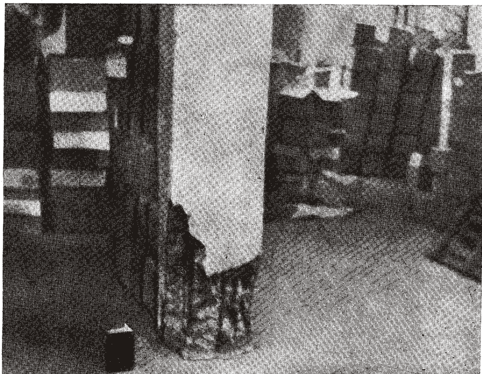
Рис. 5. Выкрашивание железобетонной колонны. Усть-Камчатск
